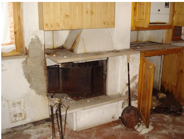
Foto 4: Camino e caldaia in soggiorno
