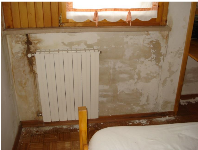
Foto 8: Radiatore su parete di tompagno in camera 1
