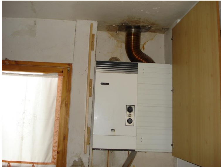
Foto 7: Caldaia per riscaldamento e produzione ACS
