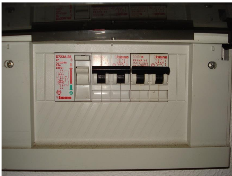
Foto 6: Centralino elettrico in soggiorno
