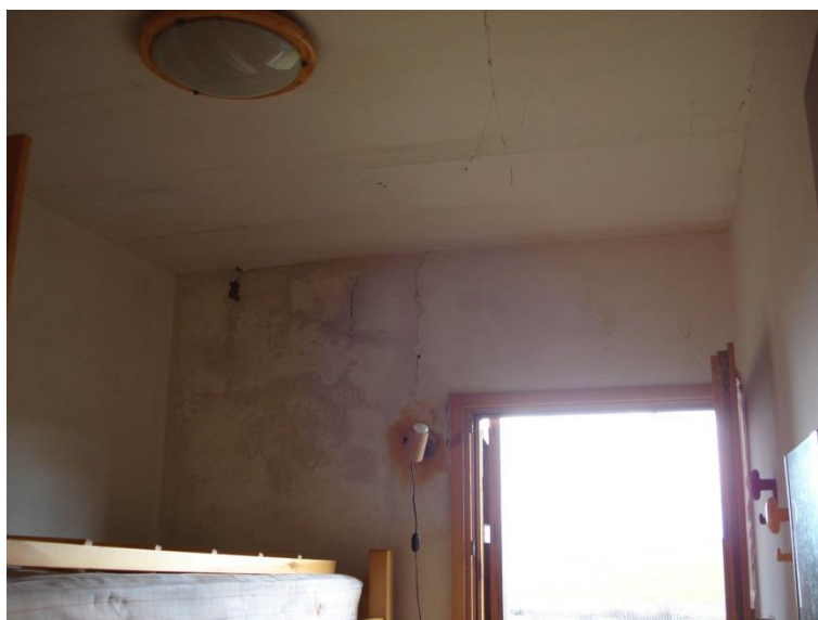
Foto 9: Parete di tompagno in camera 2
